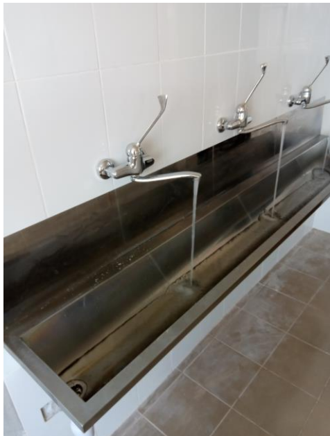
Scrub hangt en is gebruiksklaar
